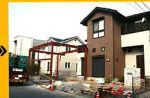
2013年1月31日、鉄骨とクレーン車がやってきて骨組みが組み立てられていく。なんと1日の作業でここまで組みあがってしまった。
